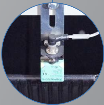
梯级缺失监测装置
